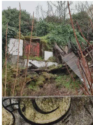
Foto 10. Pormenor do interior do edifício, com lixos e entulho
