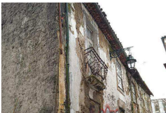
Foto 5. Pormenor do beirado, com telhas soltas ou partidas.
