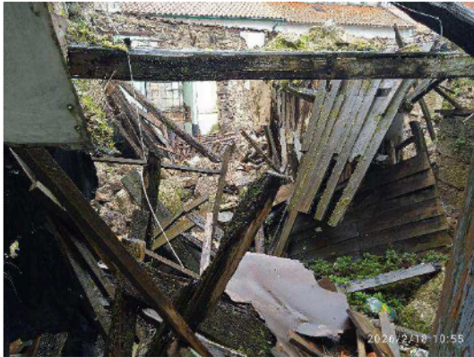
Foto 7. Pormenor do interior do edifício, com entulho
